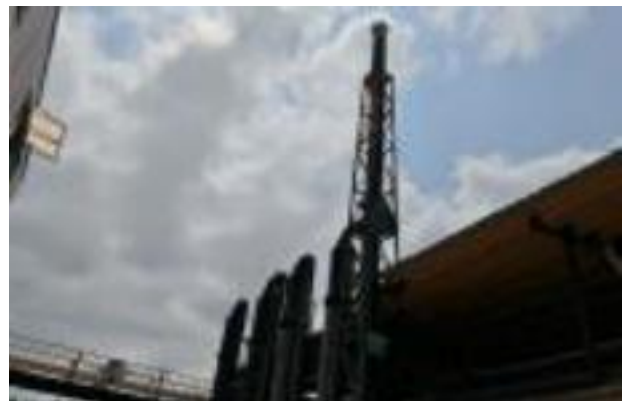
配酸区四级水喷淋吸收塔与 15m 排气筒 DA002
