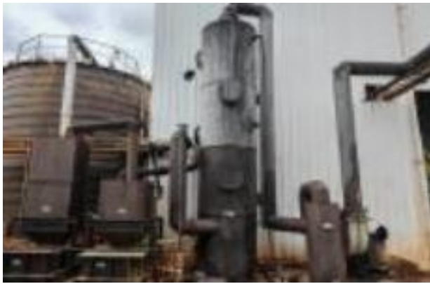
污水处理废气“二级水封水洗+一级水喷淋吸收+气液分离”装置
