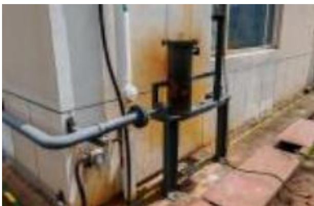
电解槽活性炭吸附保护装置
