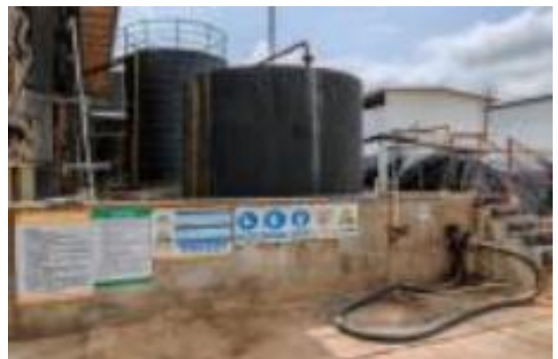
浓硫酸储罐及围堰
