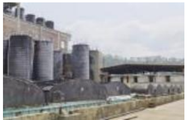
母液回收槽加盖与围堰
