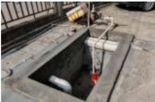
化粪池出口生活污水输送泵
