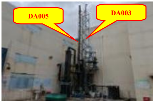
15m 电解槽氢气排气筒 DA003 与 15m 水环泵抽真空废气排气筒 DA005
