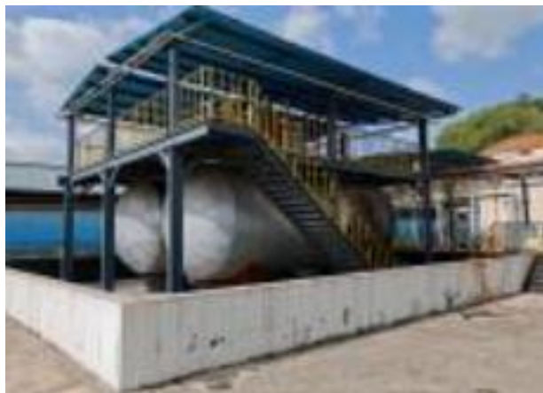
带保冷无水氢氟酸储罐与罐区围堰
