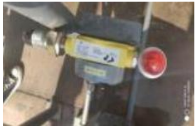
重点岗位气体泄漏报警器
