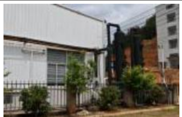
产品烘干包装岗位“水喷淋+碱喷淋”吸收装置
