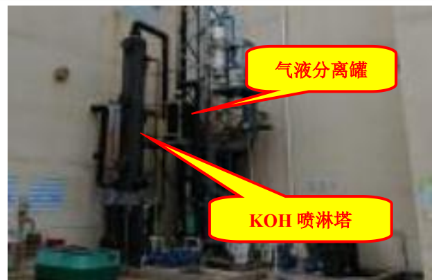
水环泵循环水储罐尾气“一级 KOH 喷淋吸收+气液分离”装置
