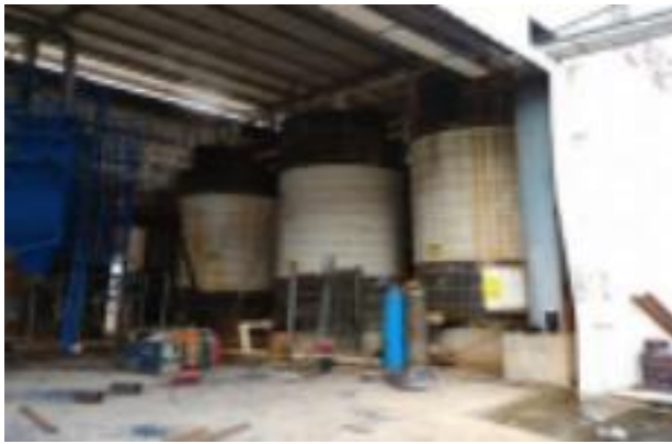
厂内污水处理装置三级絮凝沉淀
