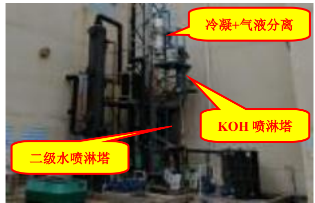
电解槽氢气“二级水喷淋吸收+一级 KOH 喷淋吸收+冷凝+气液分离”装置
