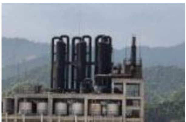
联合车间六级水喷淋吸收塔与 35m 排气筒 DA001
