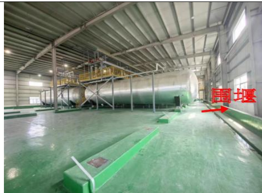
AHF 成品罐区
