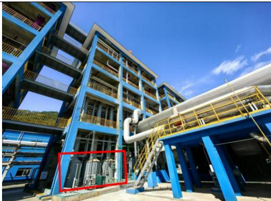
AHF 二线装置反应尾气预处理设施
