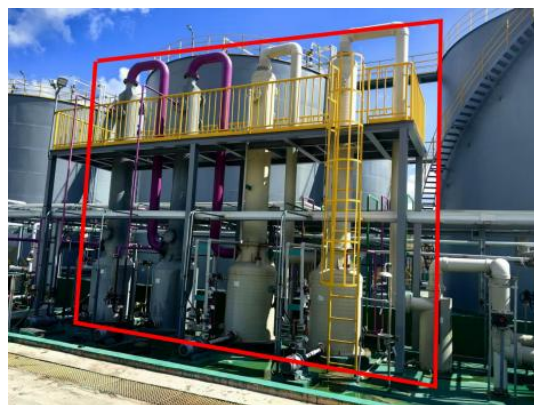
硫酸罐区(98 酸与 105 酸)废气预处理设施(2 级酸吸收 +2 级碱洗)
