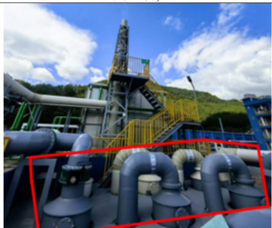
AHF 车间综合废气处理设施(3 级氢氧化钙除氟+3 级氢氧化钠脱硫)
