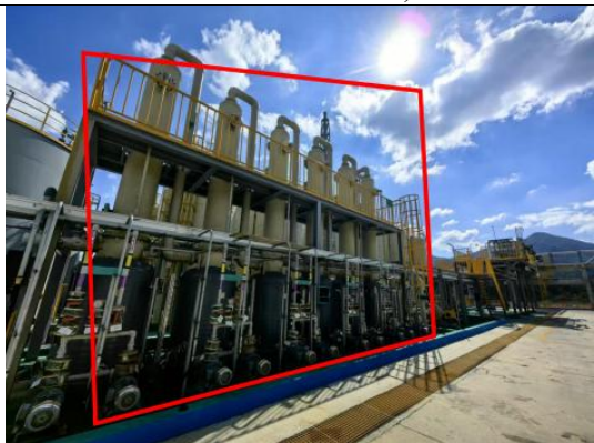
氟硅酸、氢氟酸储存与装车废气处理设施(3 级水吸收 +3 级碱洗)
