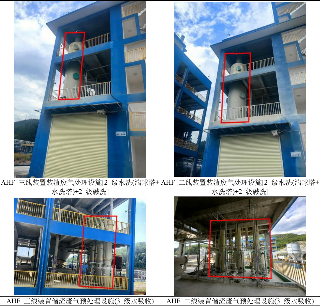
图 2.5-2 已建工程主要废气治理设施现状照片
