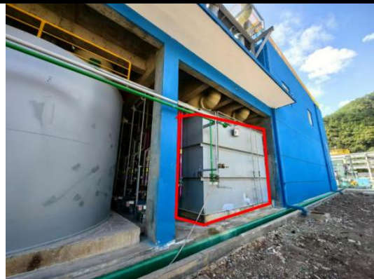
AHF 车间综合废气处理设施(3 级氢氧化钠脱硫)
