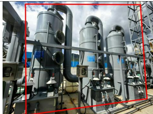
污水处理站废气处理设施(1 级酸洗+1 级碱洗+1 级水洗)
