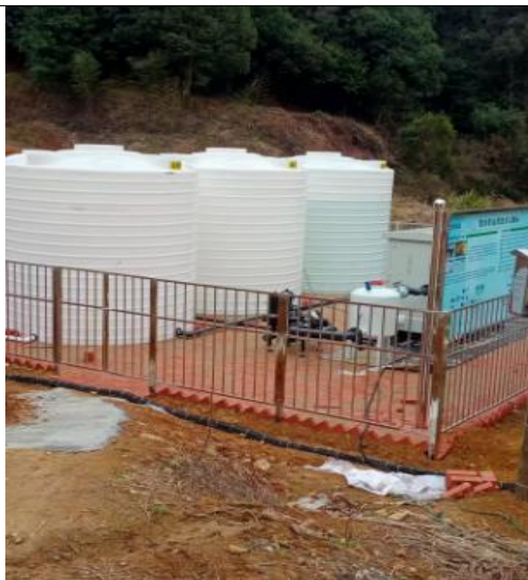
配肥站及储液罐
